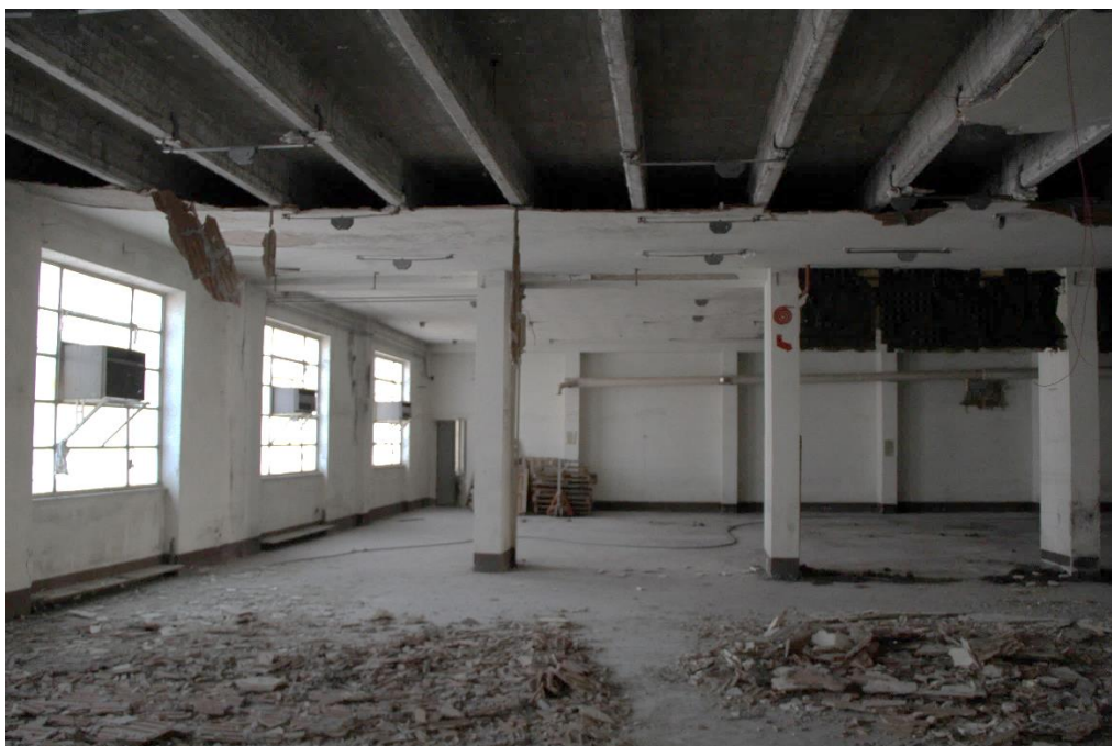
Figura 7: Fotografia rappresentativa degli interni d'edificio
