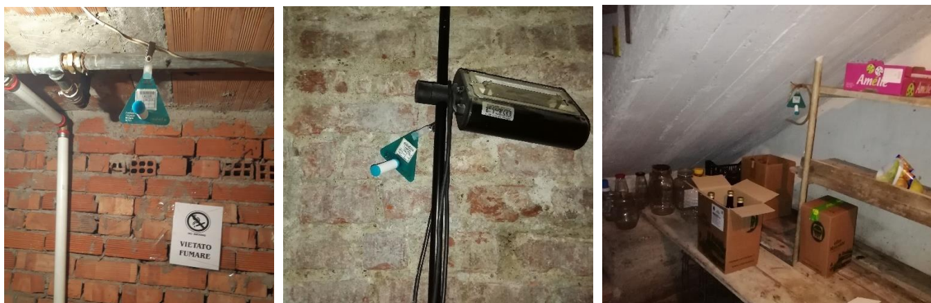
Figura 8 - Campionatori passivi alloggiati all'interno dei locali interrati di Spinetta Marengo
