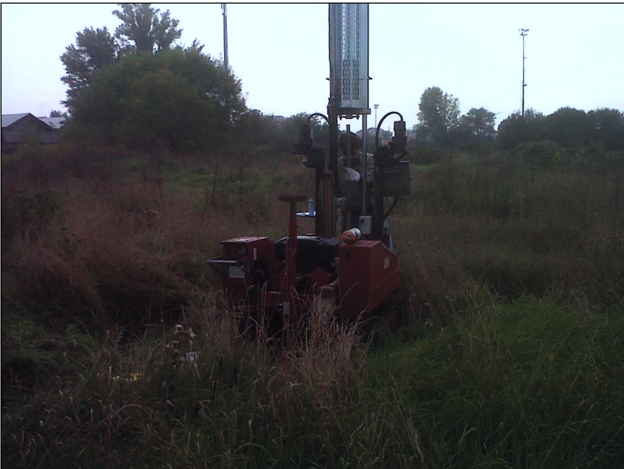
Penetrometro pagani TG 63-100 KN - area comparto 1 Via Scazzola, EDIFICI DI CIVILE ABITAZIONE IN PROGETTO - Data: 10-11 ottobre 2012.
